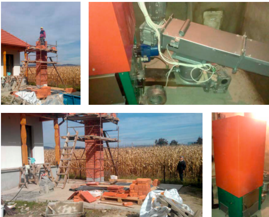
Figura 25. Noua centrală termică Kajan Karoly din Târgu. Secuiesc (Sursa: ERPEK IND SRL și ISPE).
