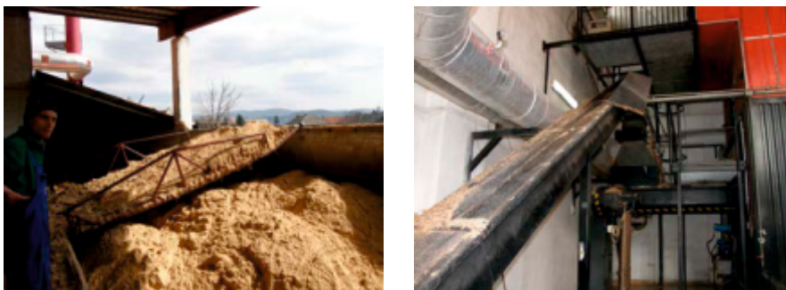
Figura 15. Centrala termică Întorsura Buzăului
