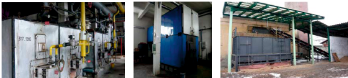
Figura 26. Echipamentul vechi/nou al centralelor termice – Beneficiar: URBANA Odorheiu Secuiesc (Sursa: URBANA și ISPE).
