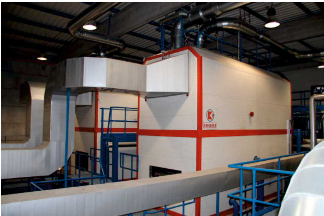
Figura 32. Două cazane pe biomasă (Kohlbach), fiecare cu o putere termică de patru megawatt, în centrala termică de cartier Banská Bystrica – Radvaň (Sursa: DOS-TRADING, Banská Bystrica).
