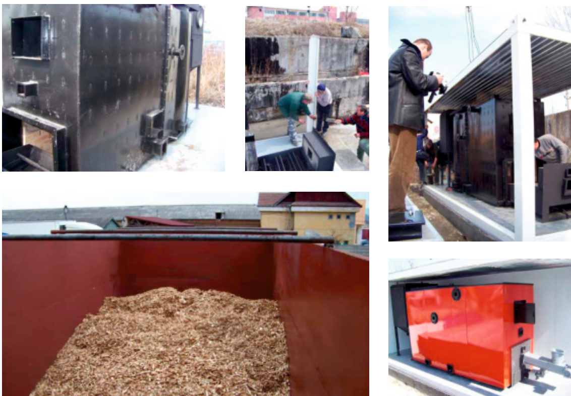
Figura 23. Noua centrală termică pe biomasă Bertis din Sfântu Gheorghe (Sursa: ISPE).
