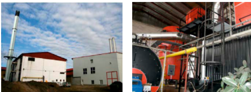
Figura 16. Centrala termică Gheorghieni
